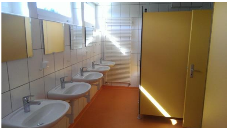
Lavabos im Waschraum
