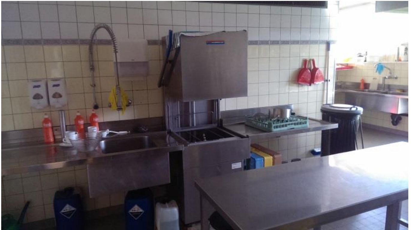
Lagerküche mit industrieller Geschirrwashmaschine und Steamer
