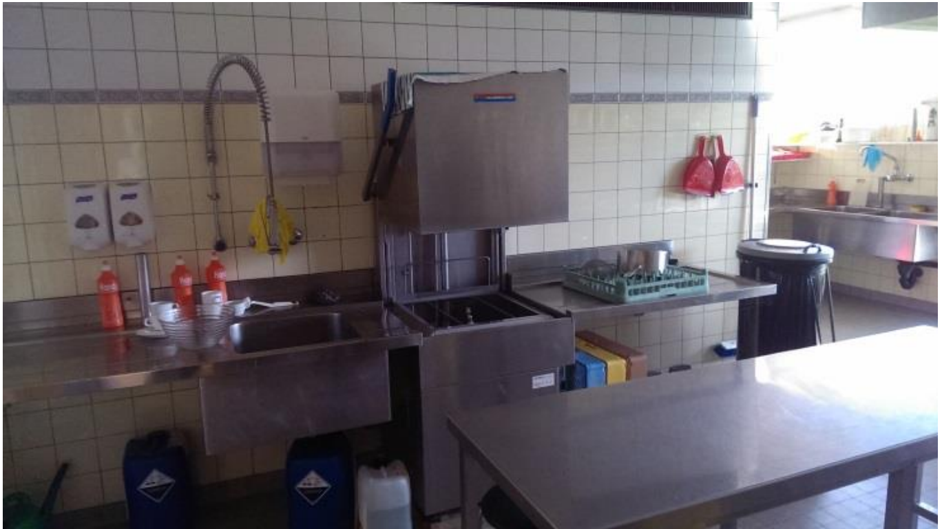
Lagerküche mit industrieller Geschirrwashmaschine und Steamer
